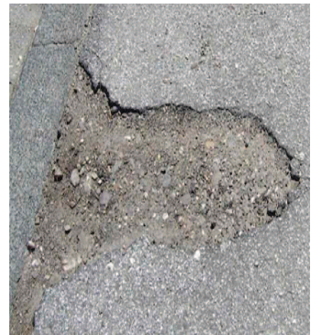
Kurzfristiger Sanierungsbedarf bei „abschnittsweise auftretenden Schäden“
